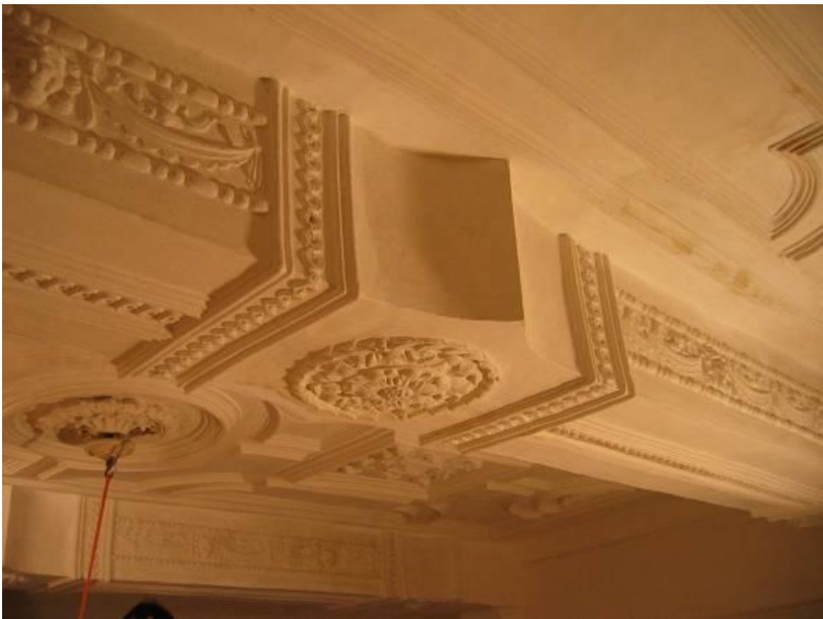
leemstucplafond in de hal na de restauratie voor het schilderen
